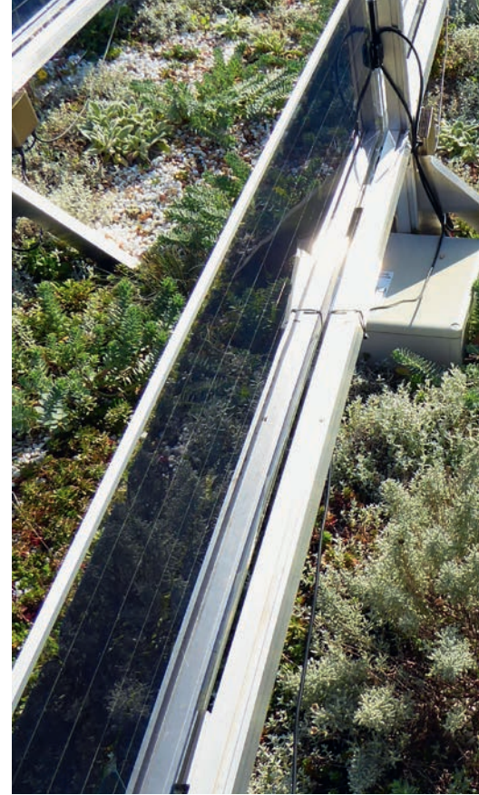
Für das Energiegründach gibt es spezielle Montagesysteme wie «Contec greenlight» (links). Eine silberlaubige Bepflanzung erhöht den Ertrag der Solaranlage (rechts). Foto: Contec (l.), Fritz Wassmann (r.)
