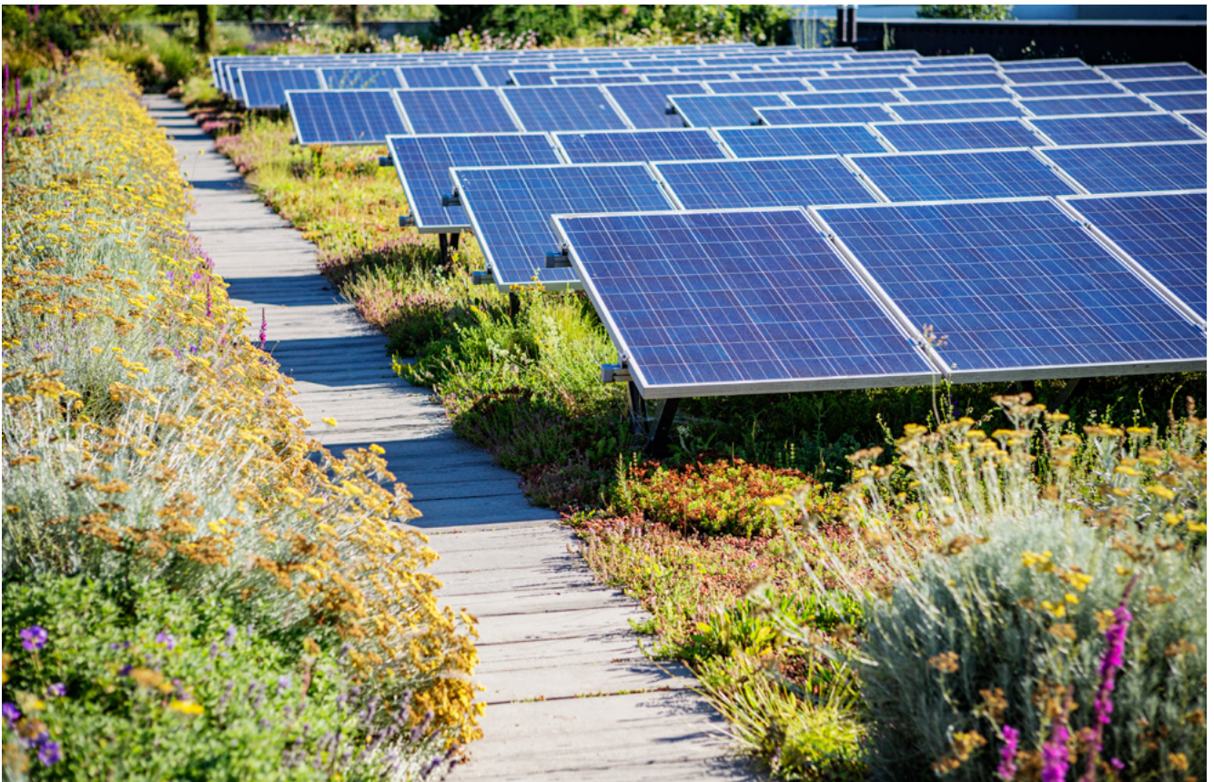
Abbildung 3: Kombination Intensiv-/Extensiv-Dachbegrünung neben PV-Anlage, Quelle: Contec
