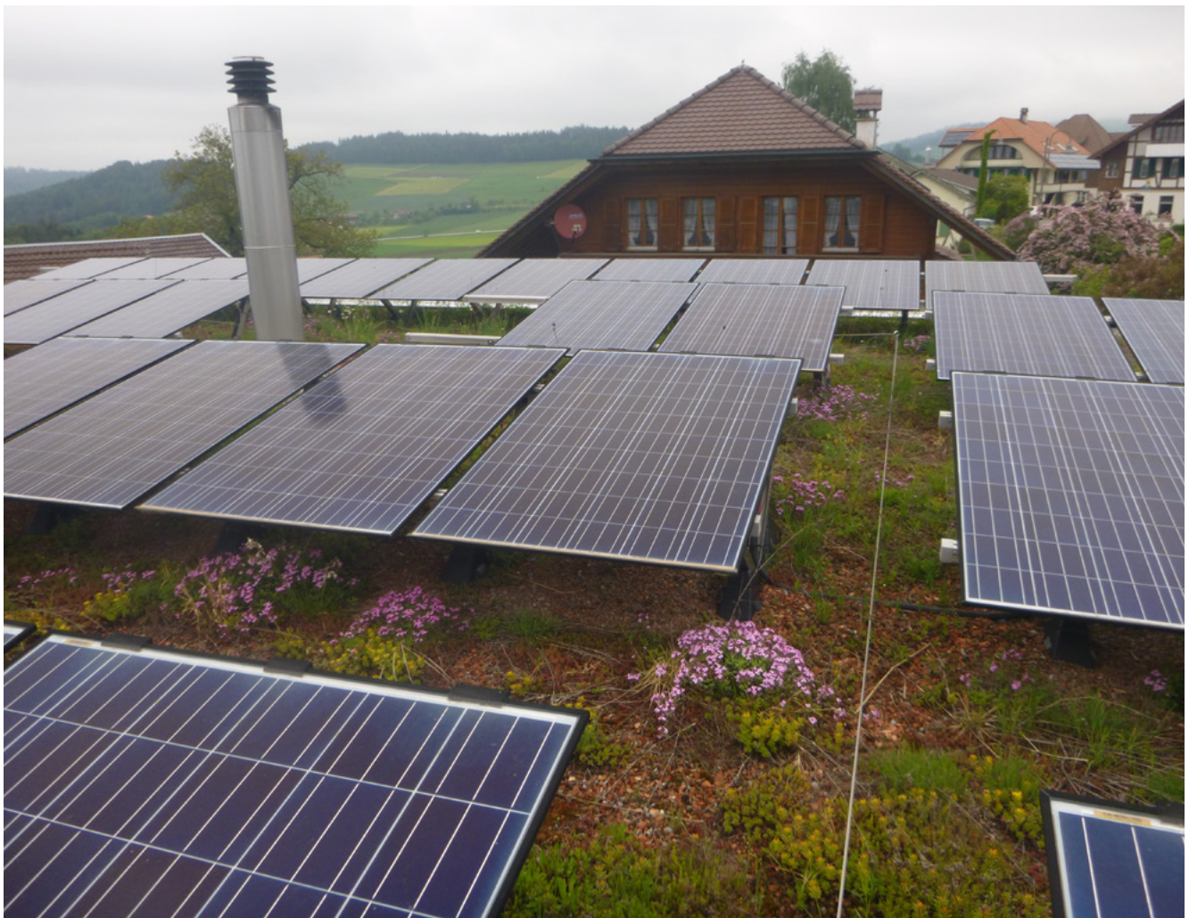
Abbildung 12: Gegen Süden ausgerichtete PV-Anlage mit modelliertem, unterschiedlich hohem Substrataufbau, Quelle: contec
