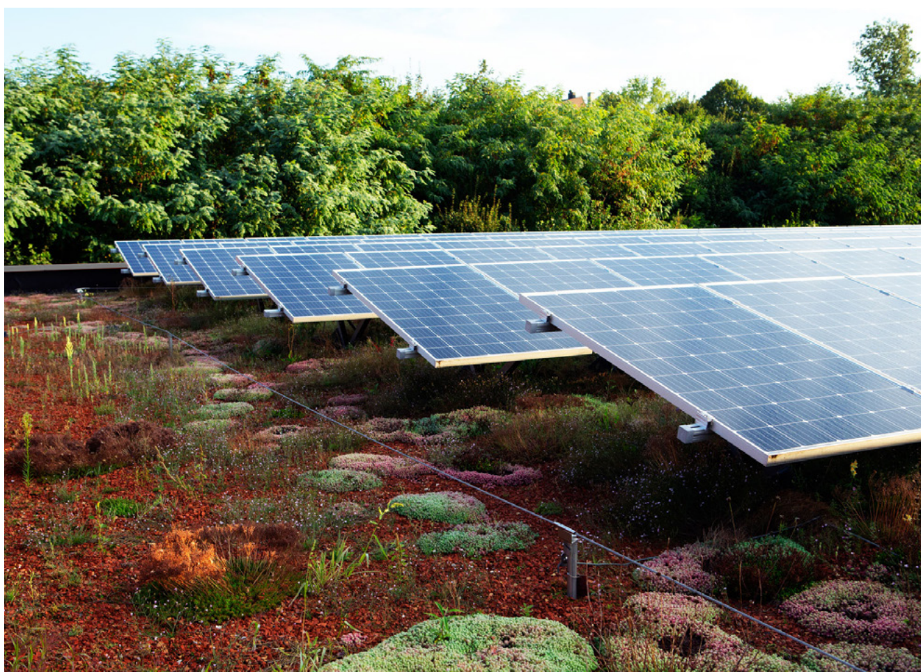
Abbildung 1: PV-Anlage kombiniert mit Extensivbegrünung, Quelle: contec
