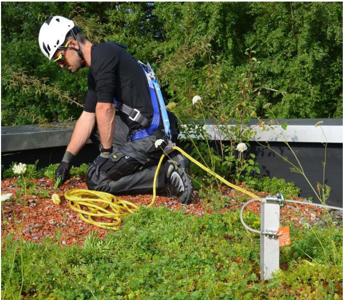
Abbildung 20: Arbeits- und Personenschutz beim Unterhalt von Begrünung und Solaranlagen, Quelle: contec
